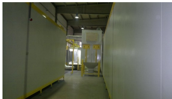
łatwa komunikacja pomiędzy zabudową malarni
